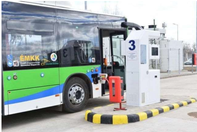
12. ábra – CNG töltőállomás
